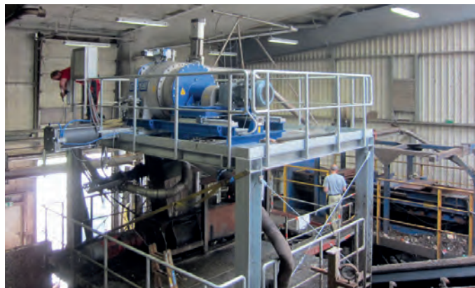
das neu entwickelte Aggregat, das in Süddeutschland steht
